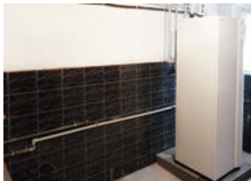
Po modernizacji kotłowni
